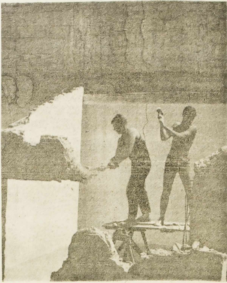
Radovi na uređenju nove ljetnje pozornice, na Kaštelu, odvijaju se, gotovo neprimjetno, već više od mjesec dana.
